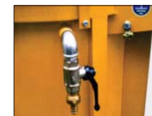
Robinet de chargement de l'eau
