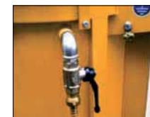
Torneira da carga de água
