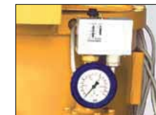
Grupo de controlo da pressão
